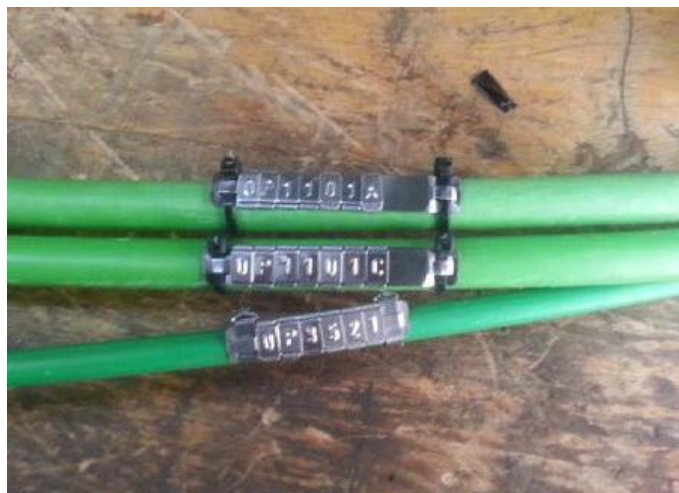
Exempel på märkning av optokabel.
